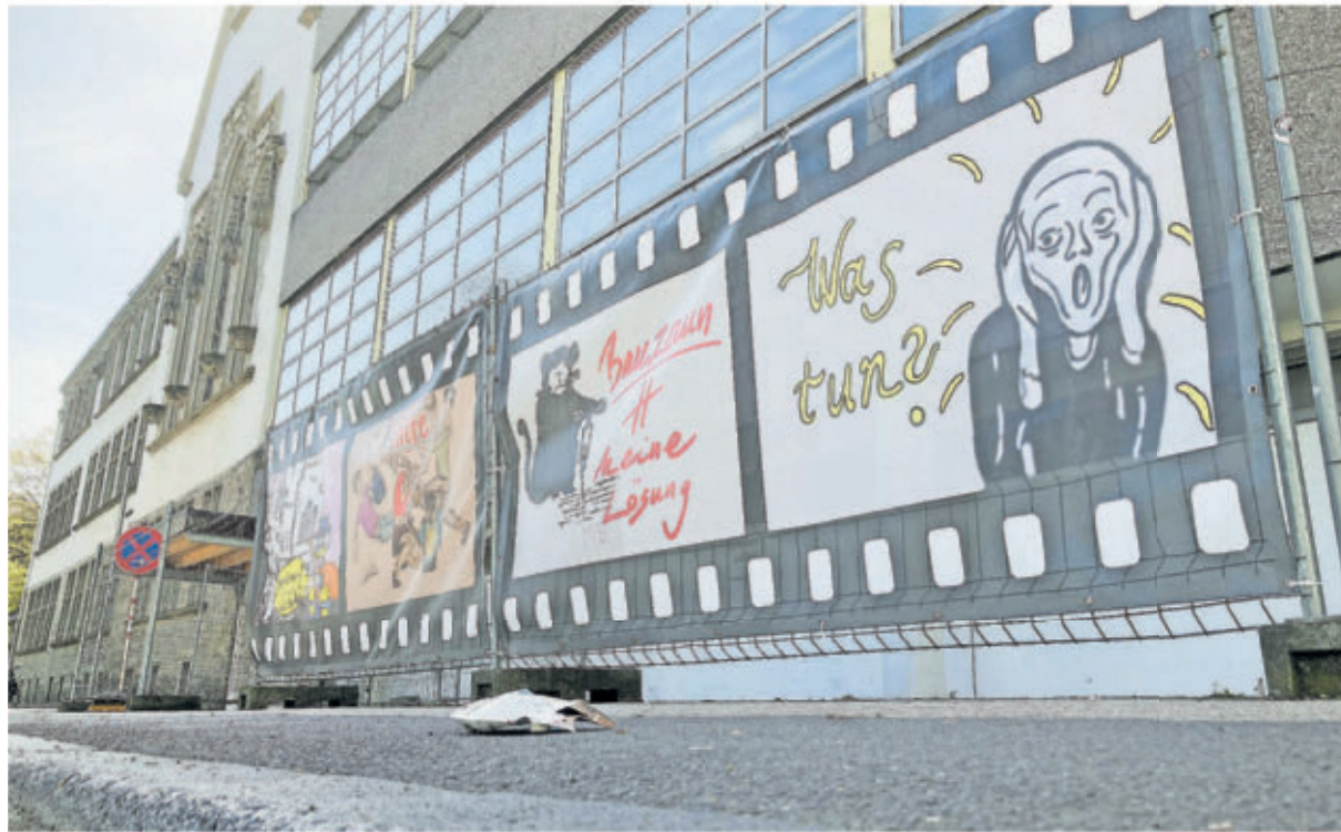
Seit Jahren sollen Bauzäune am Trierer MPG verhindern, dass abstürzende Gebäudeteile Passanten treffen. Schüler des Gymnasiums haben nun Plakate gestaltet, um auf die desaströsen Zustände aufmerksam zu machen. Sie hängen dort seit den Osterferien. Das zuständige Amt für Schulen und Sport hat auf der gegenüberliegenden Straßenseite Büros.
